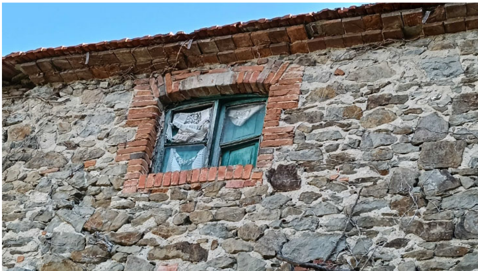
P1- GRONDA E RIQUADATURE FINESTRE
